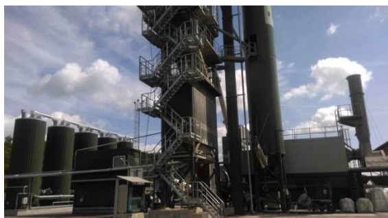
Nádrže na průběžný ohřev asfaltových směsí
